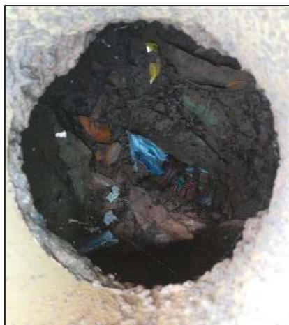
Figura 5. Válvula con observación Requiere Mantenimiento
