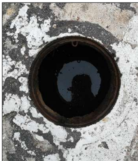
Figura 7. Válvula con observación Fuga Inundada
